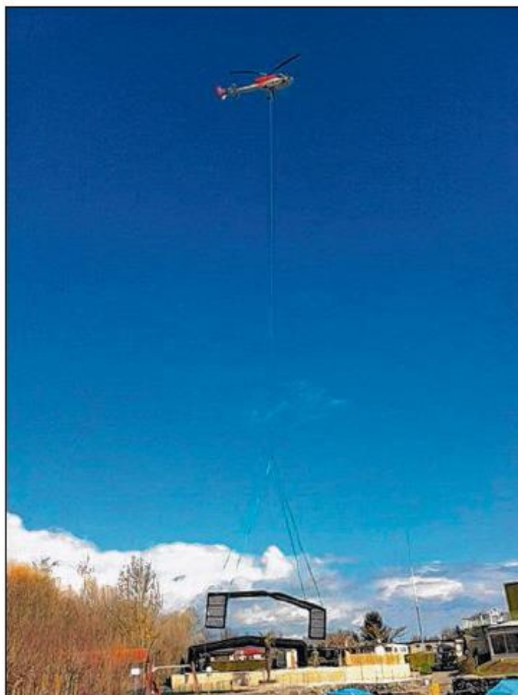
Les 15 éléments de l'abri de piscine ont été acheminés par les airs au camping des Trois-Lacs. DR
